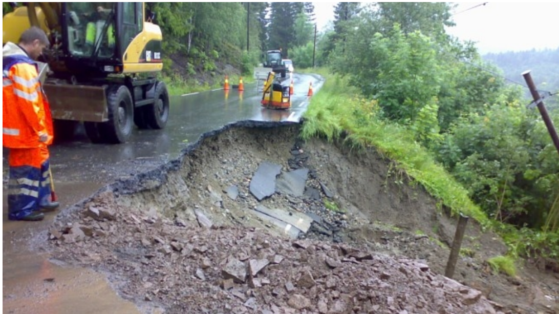
Figur 1.6.5 Fra Riksvei 284 mellom Sylling og Vikersund. Det meldes om omfattende skader på jernbane (Sørlandsbanen og Bergensbanen) og veinett pga ras/utglidning av masse. Foto: NRK /Bjørn Nybro Nielsen
