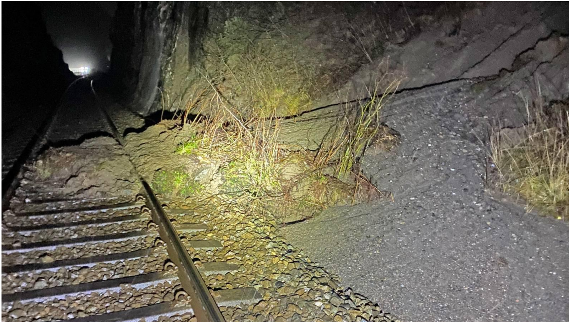
Eit jordras hadde gått over skinnene ved Stjørdal, noko som førte til at Nordlandsbanen måtte stengast. Foto: Bane Nor / NRK
