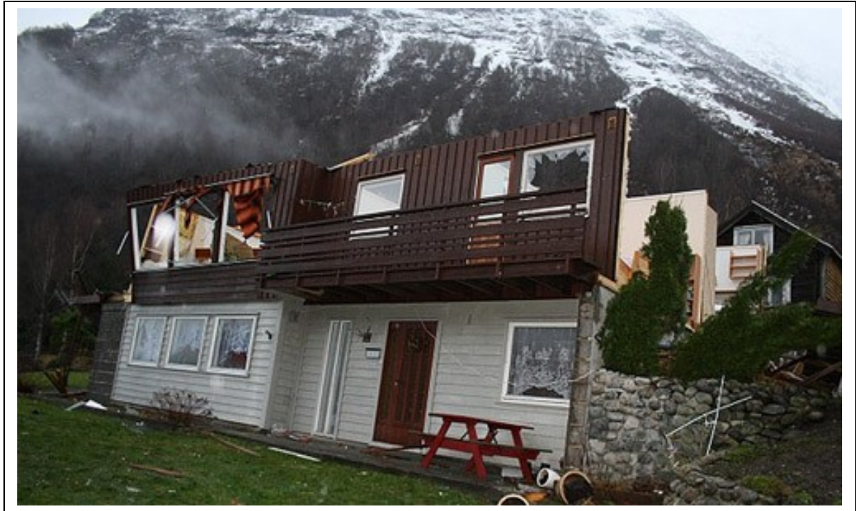
Bilete nr. 8 frå Sunnfjord energi. Enorme øydeleggingar på hus i Lodalen
