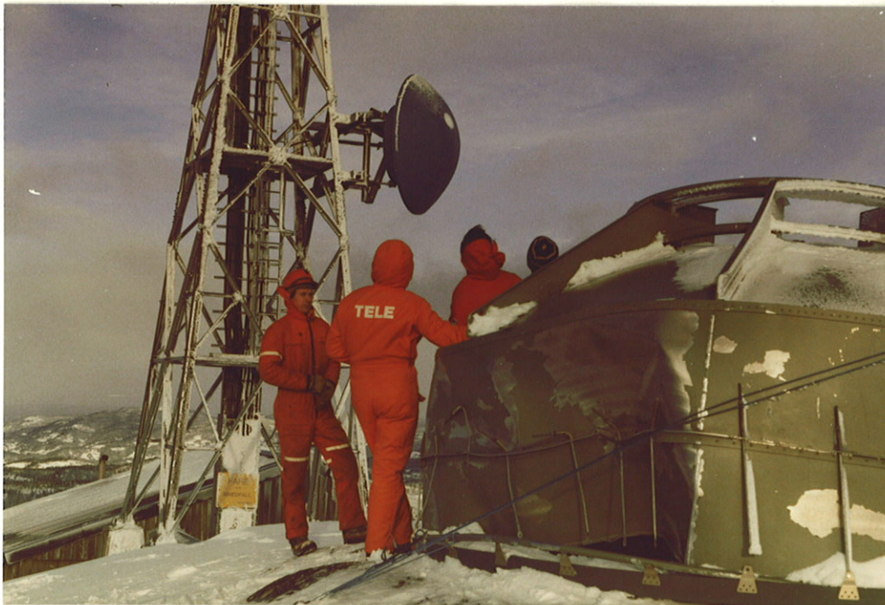
Figur 5. Skadet antenne demontert i forgrunnen. Erstatningsantennen montert i masten. (sees også nederst på figur 3).
