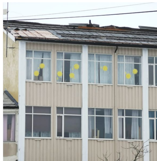
Løse takplater på barneskolen i Lødningen. Foto: Rita Pettersen Tolnes
