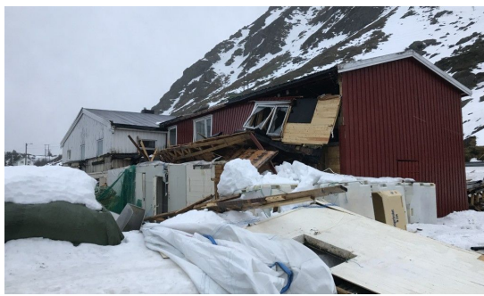
“Den sterke vinden har ført til store ødeleggelser på dette bygget.” Foto: Politiet
