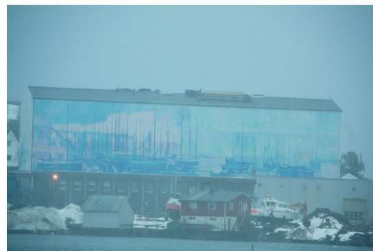
“Takplater ble revet av taket på Ballstad slip.” Foto: Avisen Lofoten
