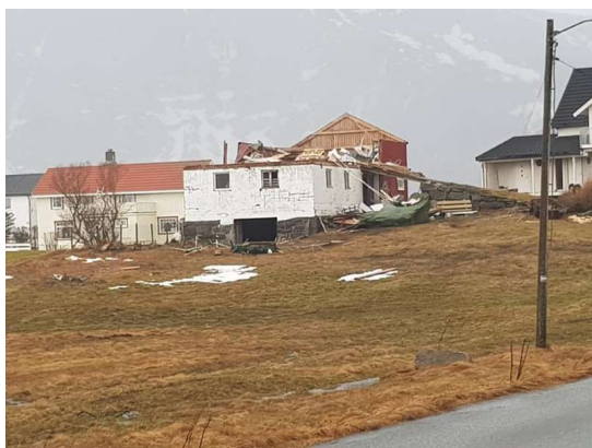
”Andre etasje av fjøs blåst av på Værøy.” Foto: Günter Reinfeld
