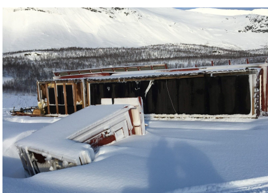
“Tidtakerbua og utedoet ved lysløypa på Kobbskaret i Sørfold ble tatt av vinden og kastet omlag 25 meter avgårde”. Foto: Arne-Harry Nilsen
