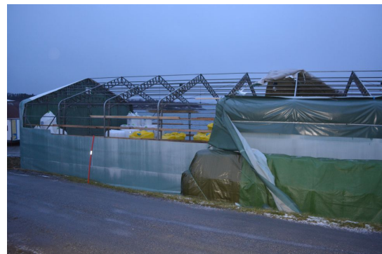
Plasthallen til Felleskjøpet på Skjerstad ble sterkt skadet. (Foto: Ole Kristian Andreassen)
