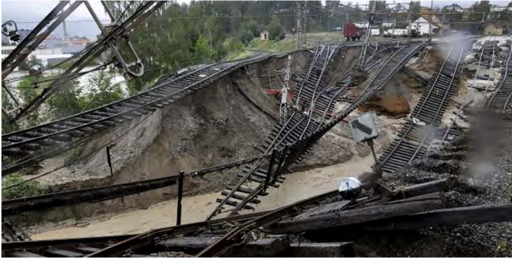
Figur 5.9: Store skader på Notodden stasjon under forrige flom 24.07.2011 (Foto: Telen)
