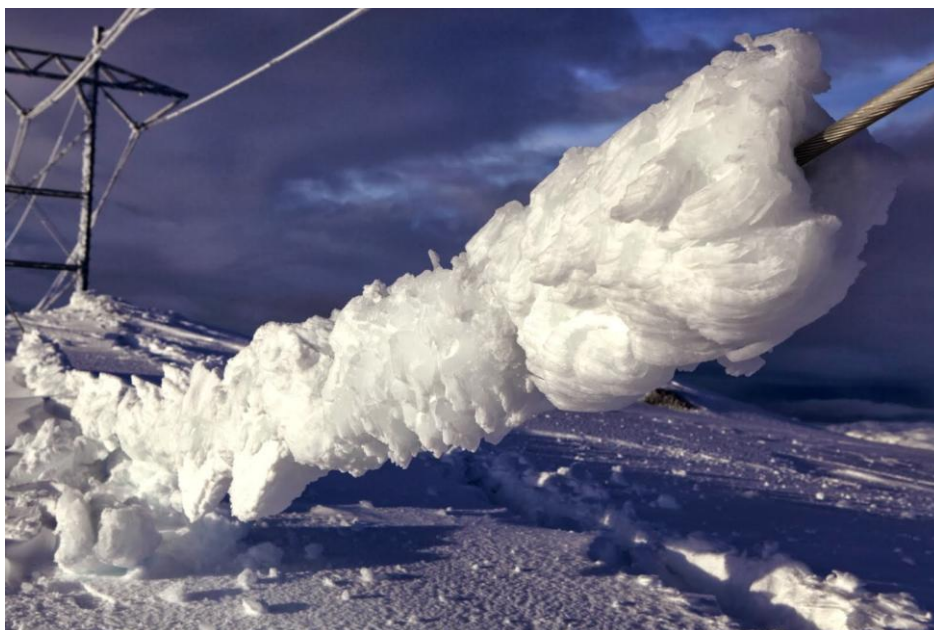
Figur 2: Ising på røket toppline (OPGW) datert 09.01.2014. Foto: Ole Gustav Berg
