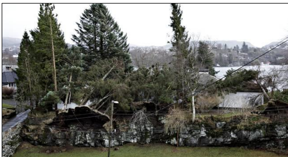
Figur 11: I vindkastene under ekstremværet Nina veltet hele 17 grantrær over et hus i Bergen.
