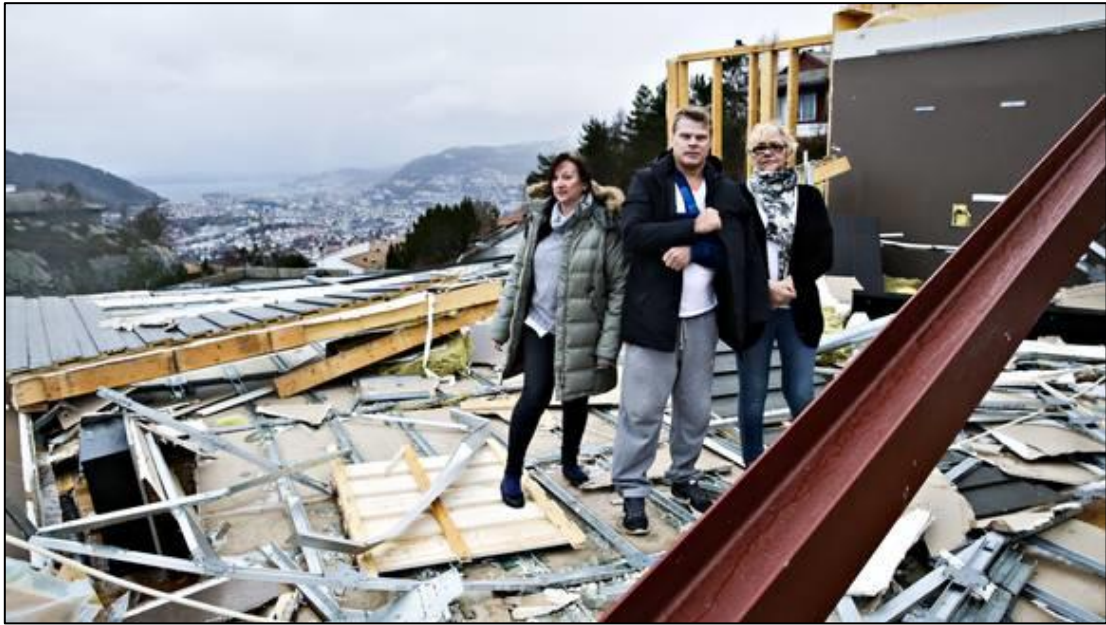
Figur 12: På Nattlandsfjellet i Bergen blåste andre etasje i et leilighetskompleks helt vekk. http://www.bt.no/nyheter/lokalt/Annen-etasje-blaste-bort-3278781.html
