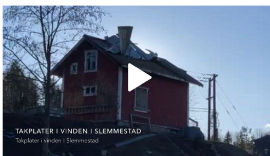
Brannvesenet måtte søndag rykke ut for å sikre takplater på et bygg i Slemmestad.
