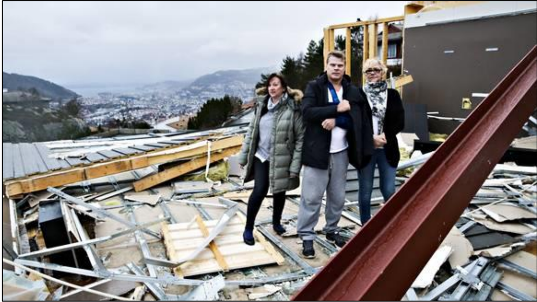
Figur 12: På Nattlandsfjellet i Bergen blåste andre etasje i et leilighetskompleks helt vekk. http://www.bt.no/nyheter/lokalt/Annen-etasje-blaste-bort-3278781.html
