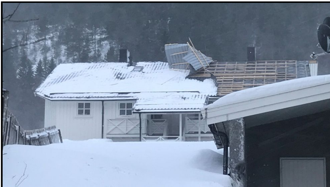
Tak ødelagt av vinden i Trøndelag
