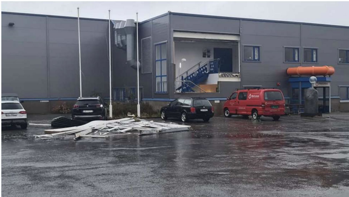
Figur 6: Bygget til Norlense på Fiskebøl på Austvågøya i Lofoten fikk deler av vegg røsket ut i stormen. Foto: Vesterålen Avis
