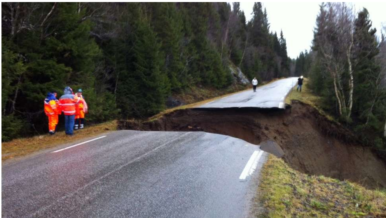
Figur 1.6.1 Flere meter av veien tatt av skred. Foto: Dan Ågren, Adresseavisen
